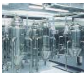
耐圧性発酵タンク
