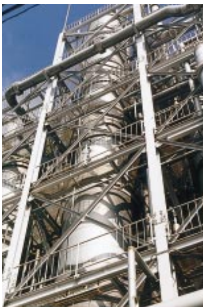
連続式蒸留機。運転はコンピューターで制御されます。
